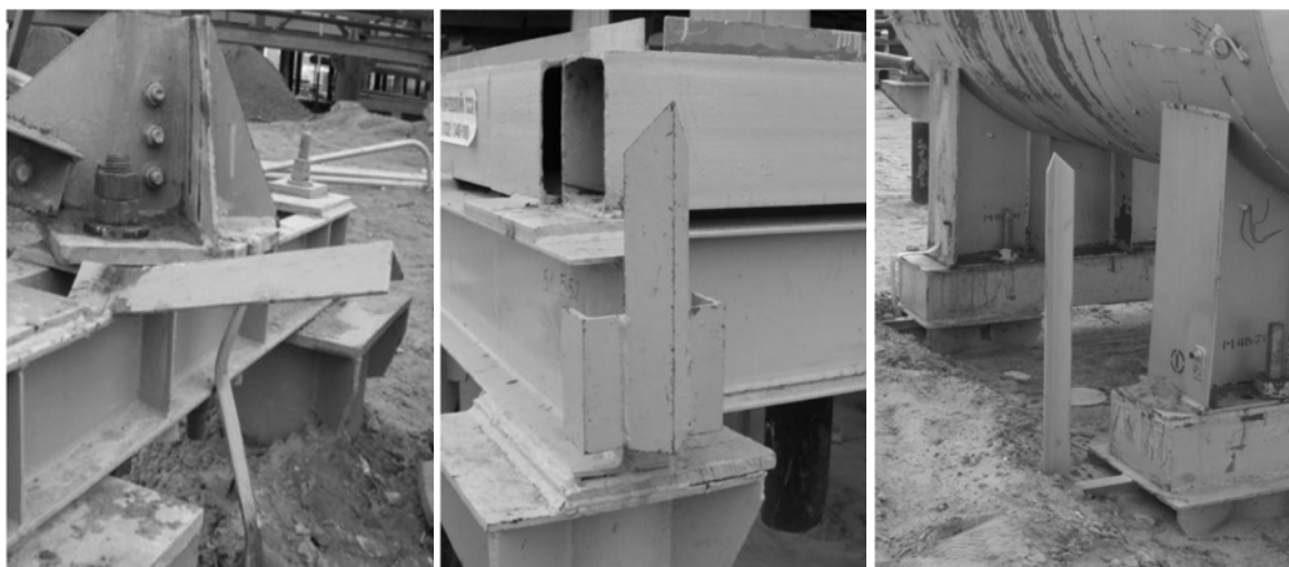
Рис. 2. Примеры неэффективных конструкций деформационных марок, задействованных в сети ГТМ в пределах одной промплощадки
